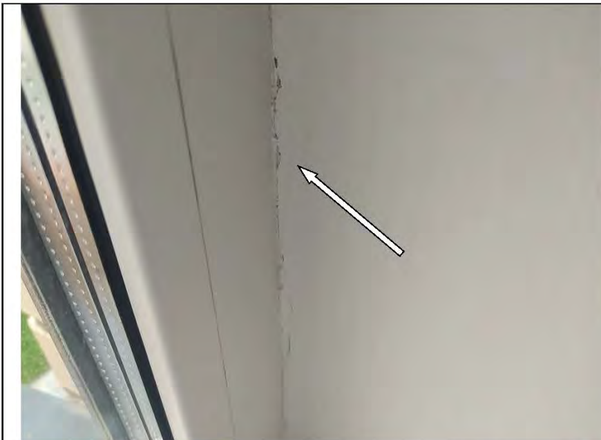
Фото №22. Окрашенные откосы оконного блока ПВХ в кухне выполнены с дефектами (отлупы).
