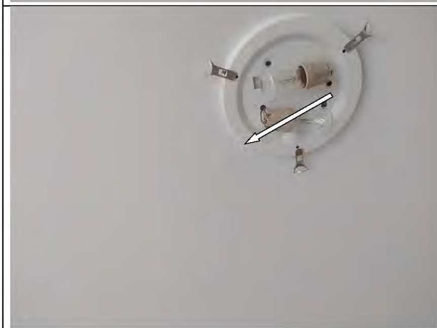
Фото №60. Дефект полотна натяжного потолка в кухне (видны инженерные сети).
