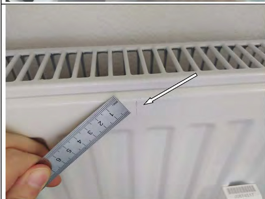
Фото №62. Отопительный прибор имеет дефект защитного кожуха в гостиной (царапина)
