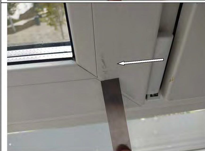
Фото №27. Профиль ПВХ оконного блока №2 в гостиной имеет дефекты (сколы).
