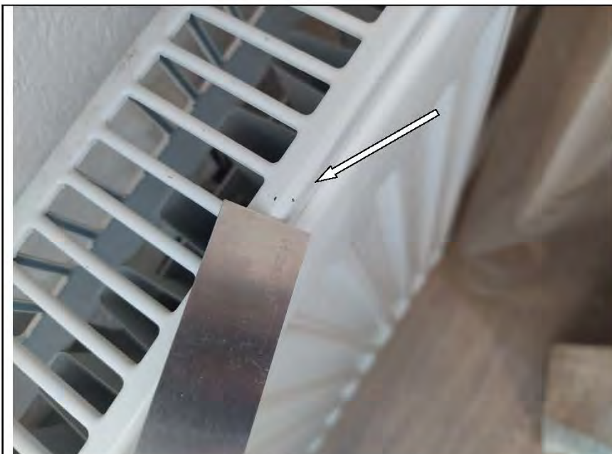
Фото №61. Отопительный прибор имеет дефект защитного кожуха в спальне (скол)
