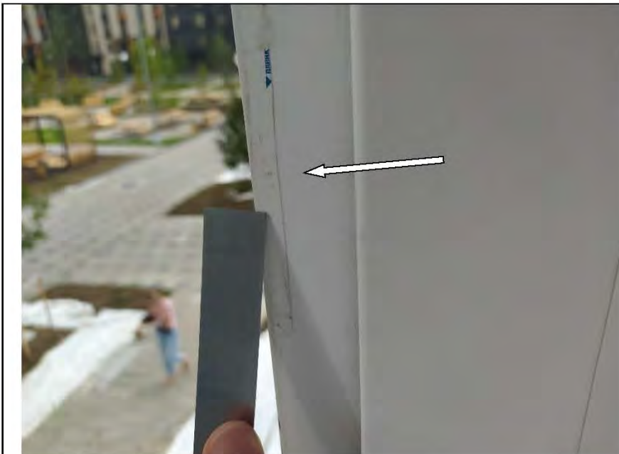
Фото №28. Профиль ПВХ оконного блока №2 в гостиной имеет дефекты (царапина).
