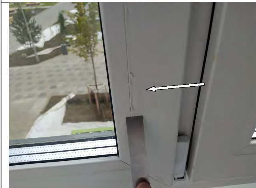
Фото №26. Профиль ПВХ оконного блока №2 в гостиной имеет дефекты (сколы).
