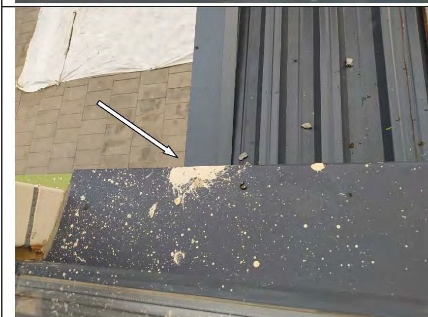
Фото №36. Металлический отлив оконного блока ПВХ в спальне имеет дефекты (загрязнение малярными составами)
