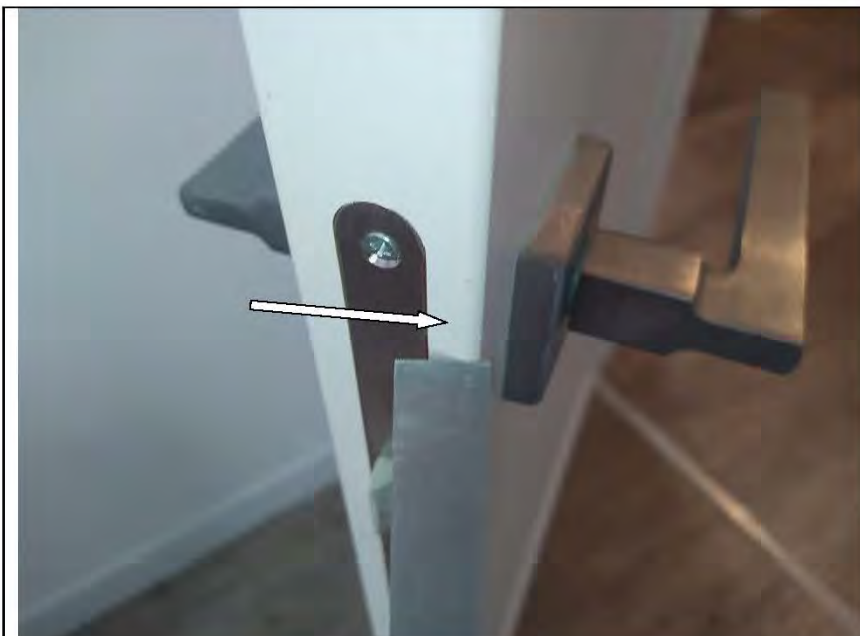
Фото №43. Дефекты (скол) на лицевой поверхности полотна деревянного дверного блока в кухне
