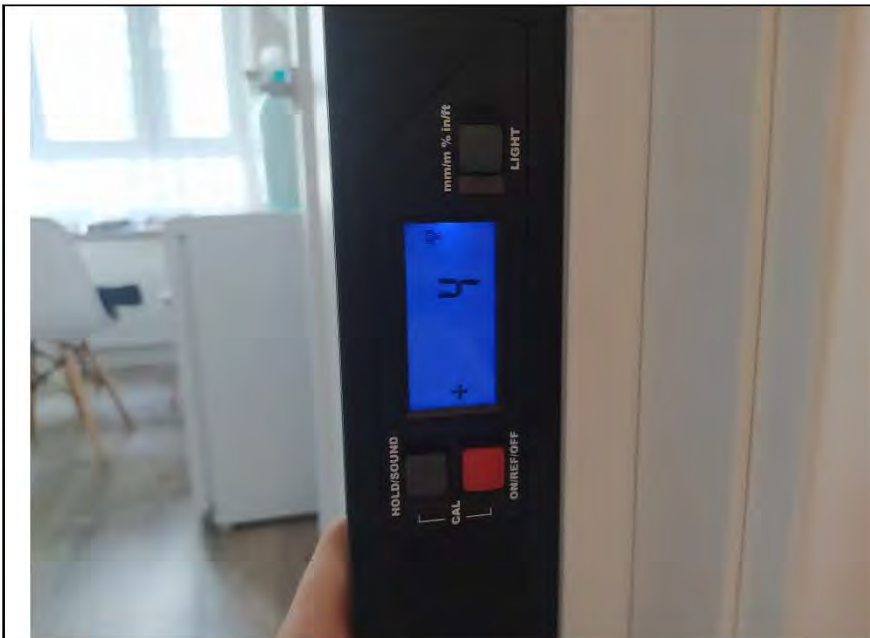
Фото №37. Отклонение коробки дверного блока в кухне.
