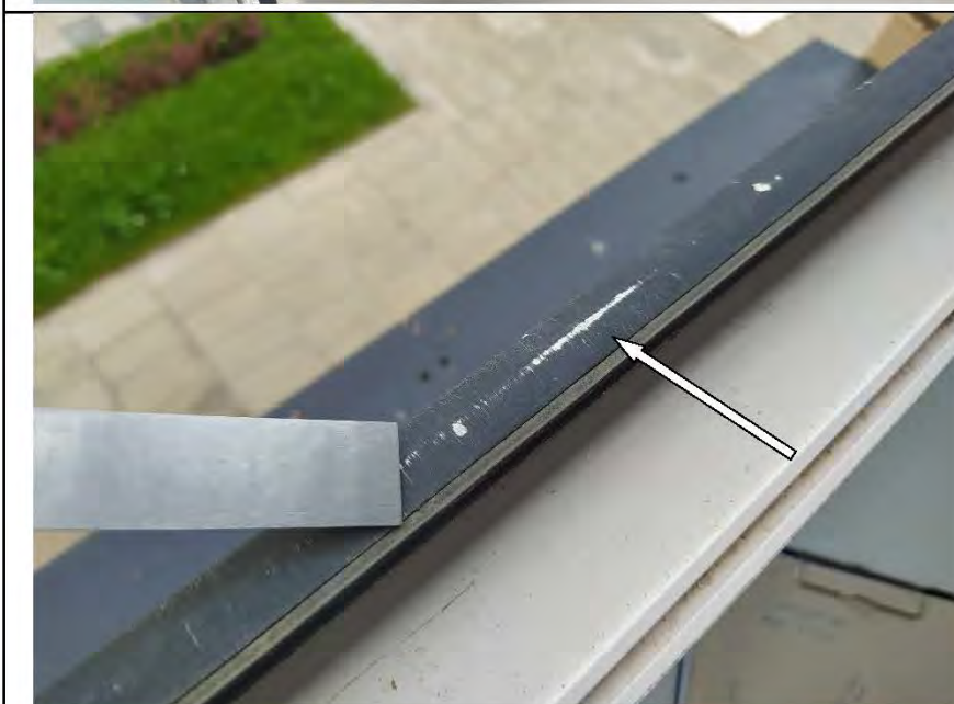
Фото №23. Профиль ПВХ оконного блока №1 в гостиной имеет дефекты (притертость).
