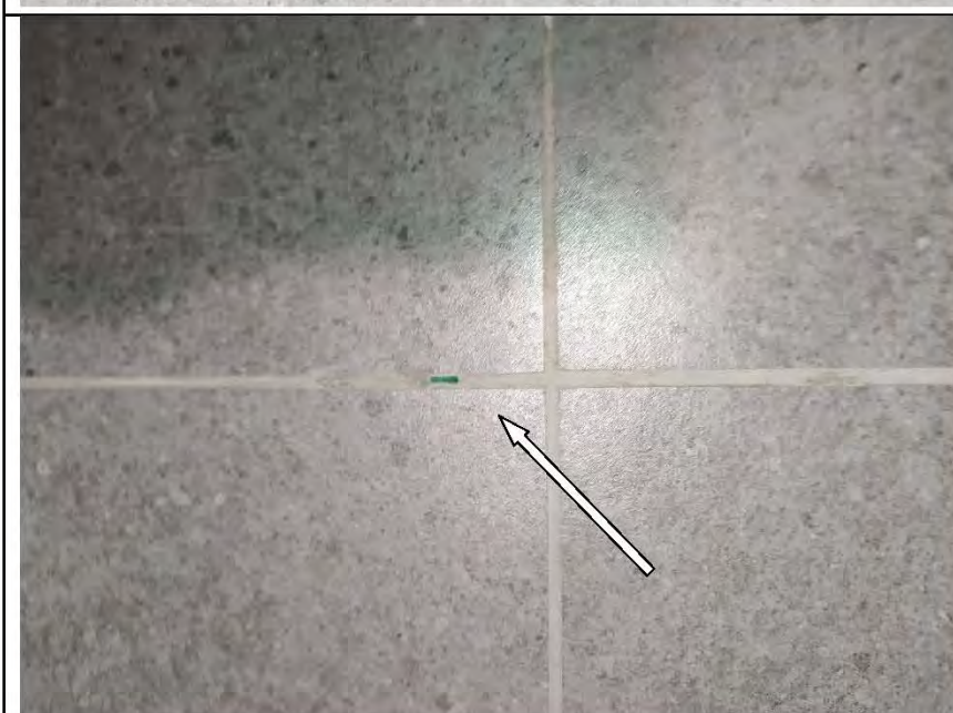
Фото №51. Затирка напольной плитки выполнена с нарушениями в ванной комнате: наличие монтажных элементов.
