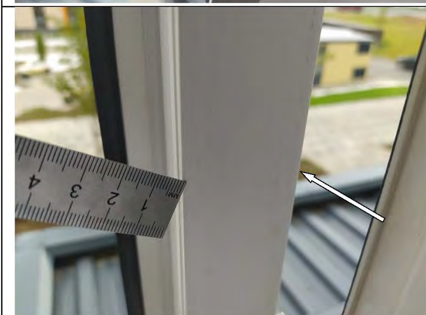
Фото №30. Профиль ПВХ оконного блока в спальне имеет дефекты (царапины).
