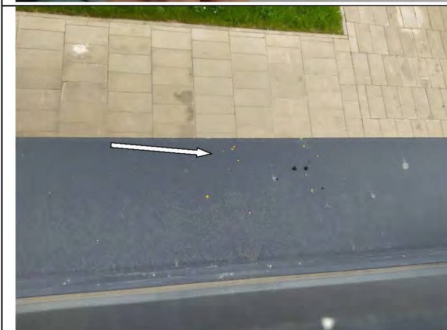
Фото №35. Металлический отлив оконного блока ПВХ в гостиной имеет дефекты (загрязнение малярными составами)
