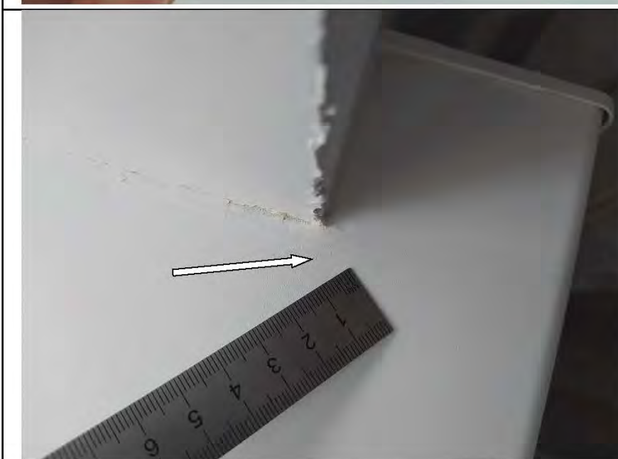
Фото №33. На лицевой поверхности подоконной доски в кухне имеются дефекты (царапины).
