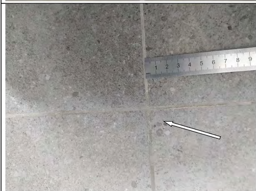
Фото №50. Затирка напольной плитки выполнена с нарушениями в санузле: разность ширины шва.
