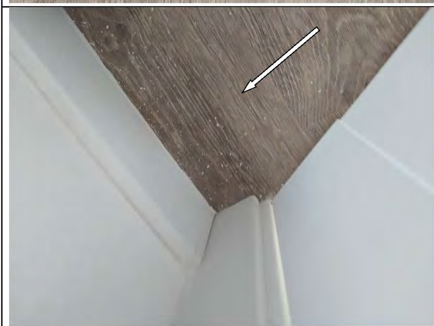
Фото №54. Загрязнения на поверхности ламината в гостиной.
