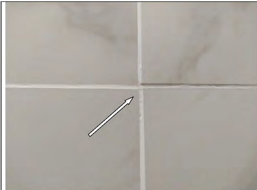
Фото №49. Затирка настенной плитки в санузле выполнена с нарушениями (каверны).
