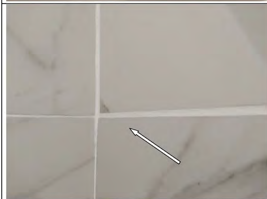
Фото №48. Затирка настенной плитки в ванной комнате выполнена с нарушениями (разность ширины шва).
