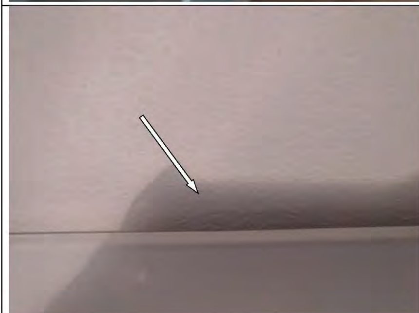
Фото №44. Неплотное прилегание дверного наличника к стене в ванной комнате.
