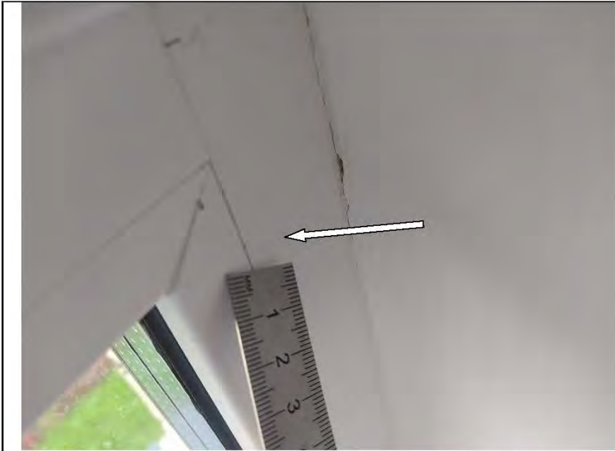
Фото №25. Профиль ПВХ оконного блока №1 в гостиной имеет дефекты (сколы).
