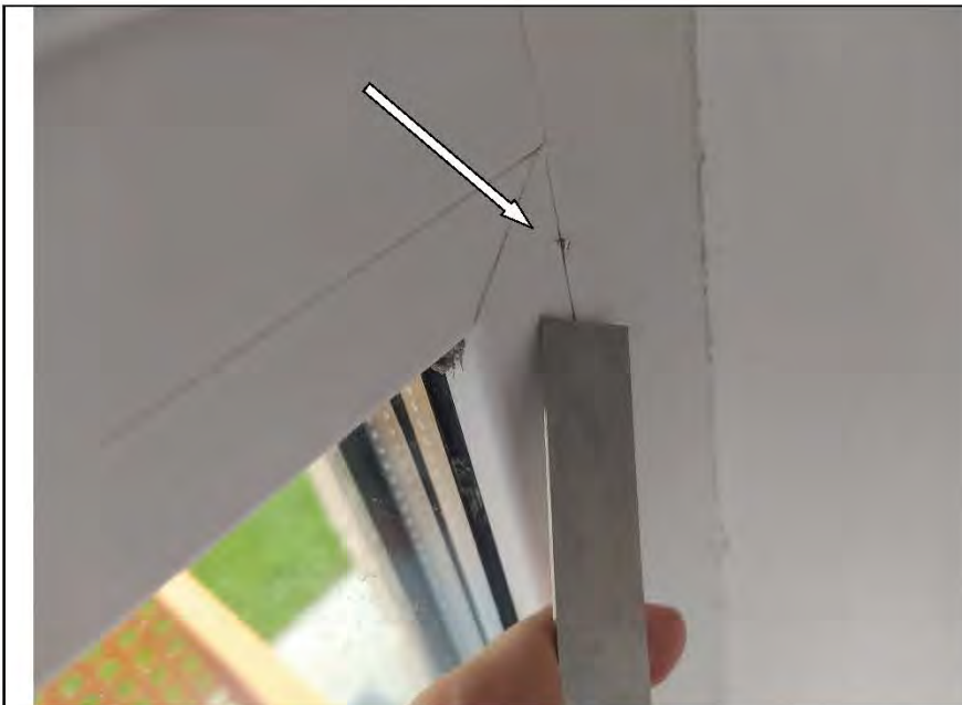
Фото №31. Профиль ПВХ оконного блока в кухне имеет дефекты (скол).
