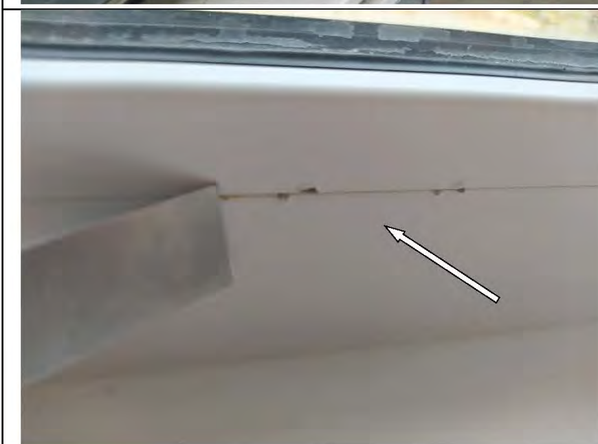
Фото №24. Профиль ПВХ оконного блока №1 в гостиной имеет дефекты (сколы).
